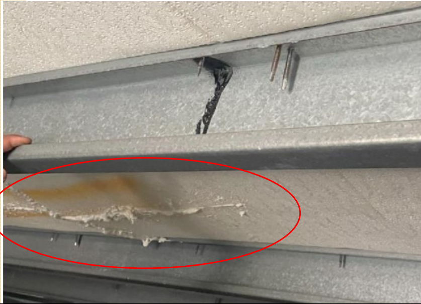
鐵皮已開裂、滲水，廠商以發泡劑填補
