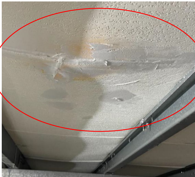
鐵皮已開裂、滲水
